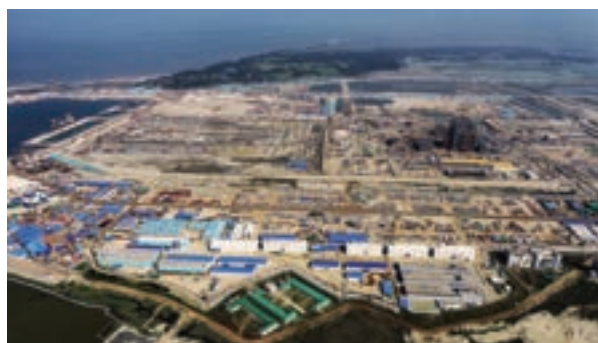
マタバリ超々臨界石炭火力発電所 建設状況 (写真: JICA(MJVC))
